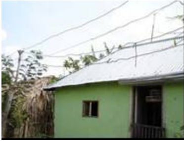
Figura 5. Cables con riesgo de contacto en Villa Katy-Sincelejo
